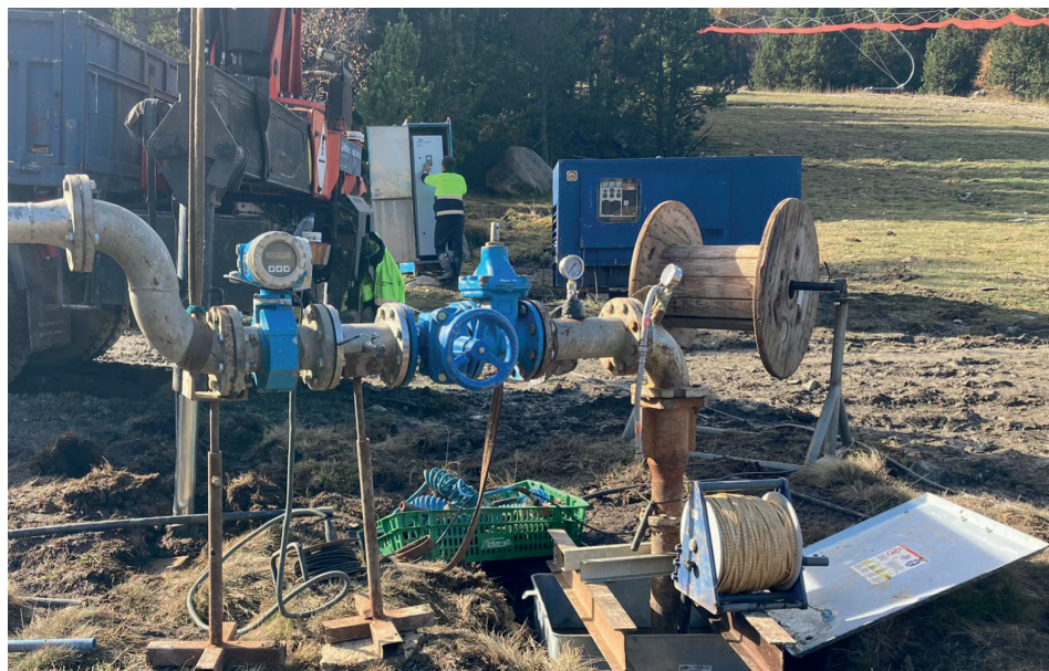
FIGURA 2. Exemple d'un pou d'extracció en el moment de fer un assaig per estudiar els paràmetres hidràulics de l'aqüífer i la sostenibilitat de l'extracció. Fotografia: Dídac Sánchez.
